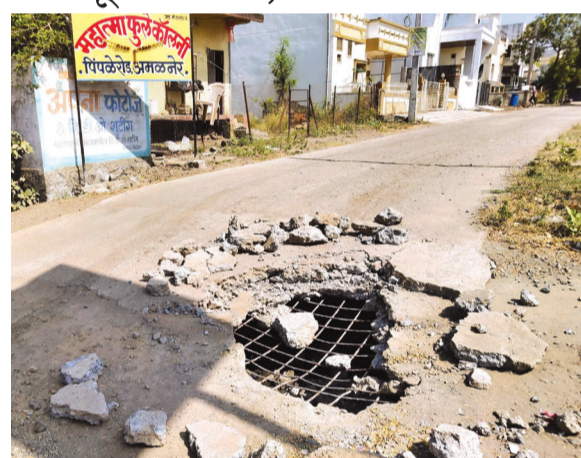
अमळनेर : पिंपळे नाल्यावरचा लहान पूल अवजड वाहनांच्या सततच्या वाहतुकीमुळे खचला आहे. (छायाचित्र : रजनीकांत पाटील)
