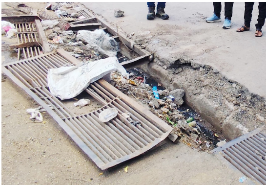
अमळनेर : पैलाडमधील मुख्य रस्त्यावरील तुटलेली जाळी.
